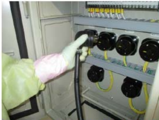
原子炉格納容器水素濃度監視電源操作 (原子炉建屋 T.P. 24.8m)
