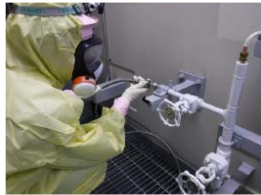
代替空気(窒素)供給用フレキシブル配管接続 (原子炉建屋 T.P. 21.2m)
