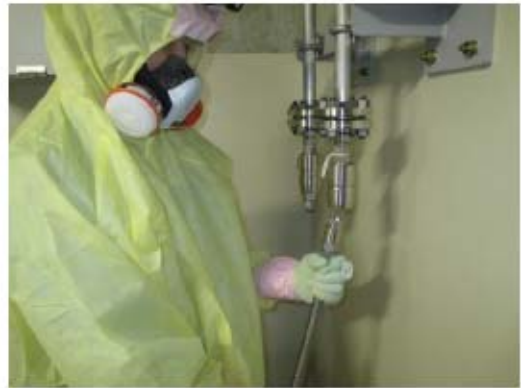
可搬型格納容器内水素濃度計測ユニット接続 (原子炉建屋 T.P. 24.8m)
