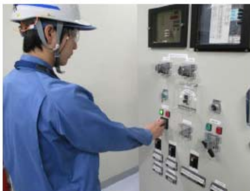
制御棒駆動装置用電源出力遮断器現場開放操作 （原子炉建屋 T.P. 17.8m）
