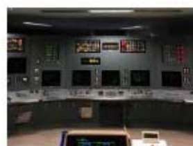
非常照明時非常用照明点灯時のイメージ (写真：シミュレータ撮影)
