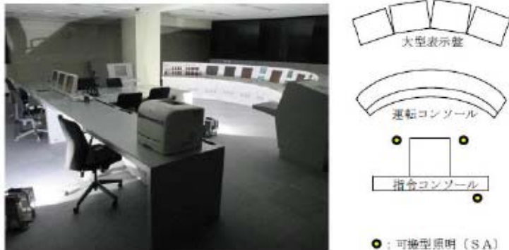
第4-4図 シミュレータにおける可搬型照明（SA）確認状況
