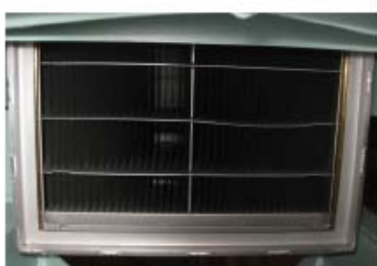
装置底部 (PAR 入口給気口)
