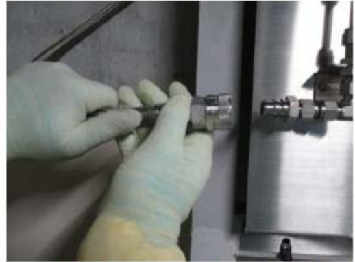
アニュラス全量排気弁操作用可搬型 窒素ガスポンペのカップラ接続 (原子炉補助建屋 T. P. 40. 3m)
