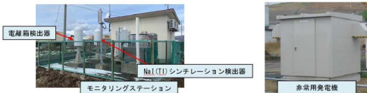
図4 モニタリングステーションの設置状況
