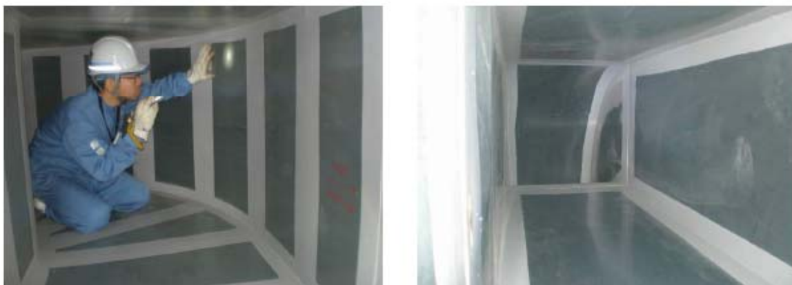
図1 中央制御室非常用循環系統ダクトの内面状況
