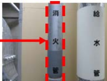
T.P. 14.3m配管室
