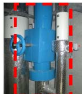
T. P. 21. 2m配管室 飲料水出入管理建屋補給弁
