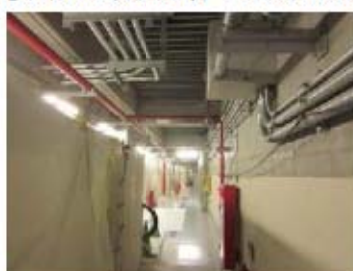
電気建屋 T.P. 10.3m通路
