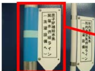
出入管理建屋 T. P. 10. 3m 管理区域入口
