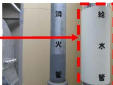
T. P. 14. 3m配管室
