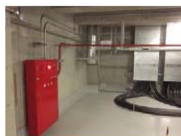
電気建屋 T.P. 7.1mケーブル処理室
