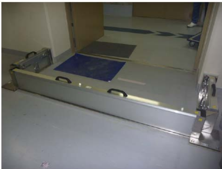
参考資料 1 添付 1-図 2 止水版写真 (1次冷却材ポンプ母線計測盤室)
