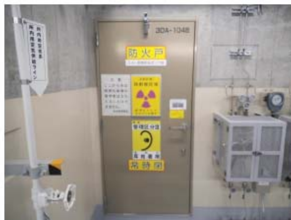
(8) A-余熱除去ポンプ室扉
