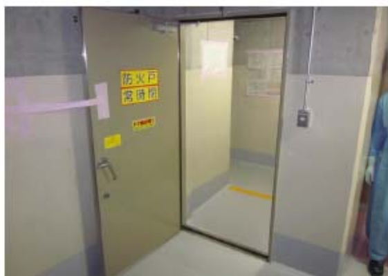
(1) B-安全補機配管室扉
