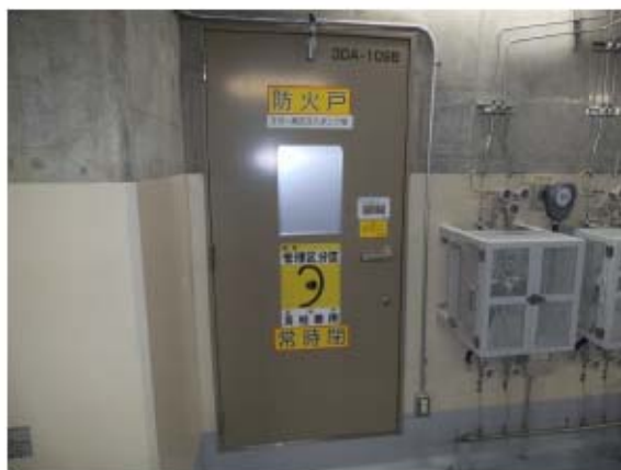
(5) B-高圧注入ポンプ室扉
