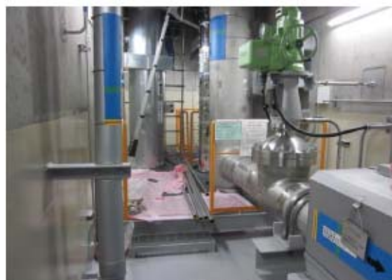
(2) B-安全補機配管室内
