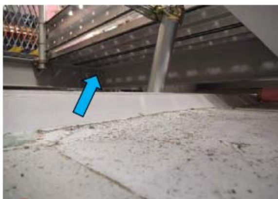
(3) B-安全補機配管室内の堰
