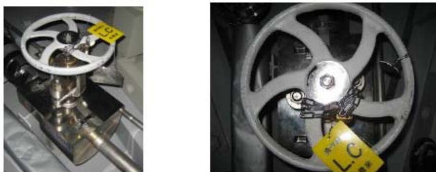
図2 弁施錠状態の例の写真
