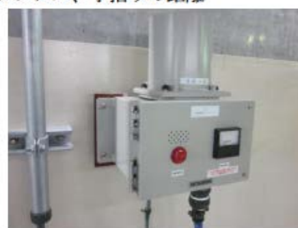
機器の固定状況
