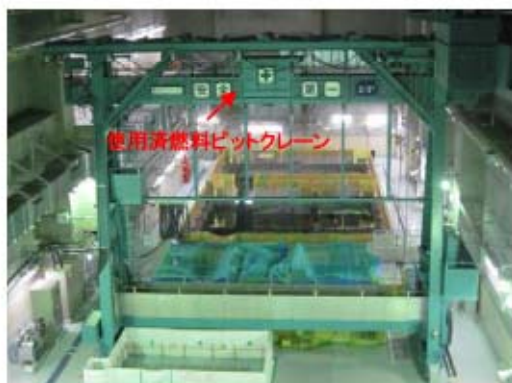
使用済燃料ピットクレーン
