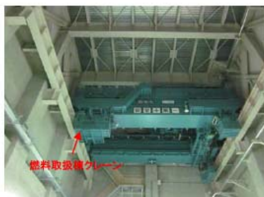
燃料取扱棟クレーン
