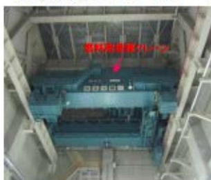
④燃料取扱棟クレーン
