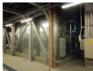
空調ユニット
