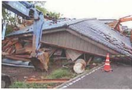
倒壊した木造構築物
