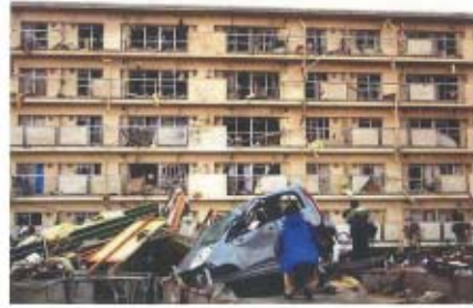
5階建て集合住宅南面の被害状況
