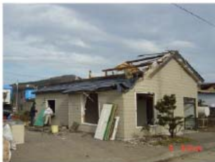
屋根全体が飛散した住宅
