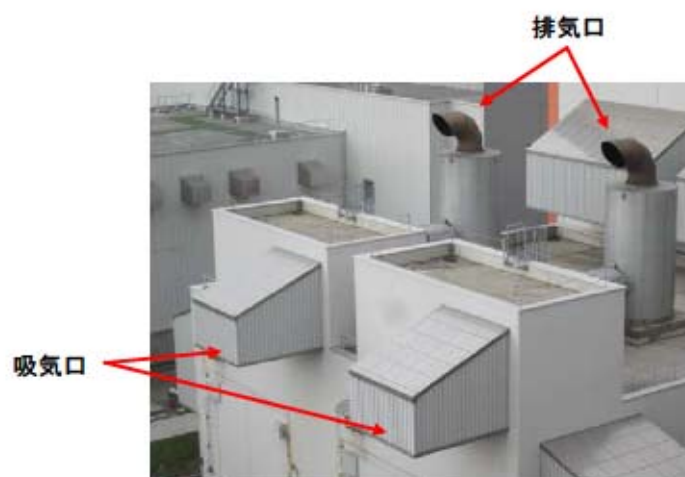
図-1 非常用ディーゼル発電機の吸排気口
