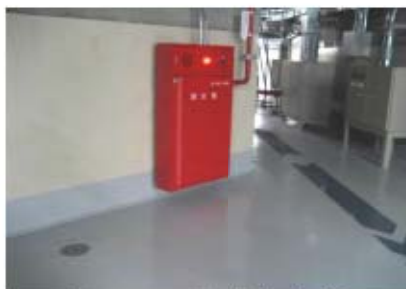
図-15 屋内消火栓
