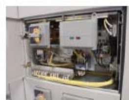
コントロールセンタ
