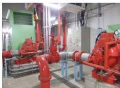
図-18 ディーゼル駆動消火ポンプ（給排水処理建屋内）
