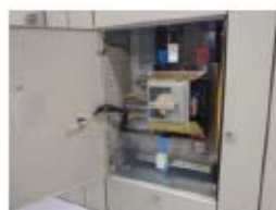
直流コントロールセンタ
