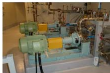
図－13 格納容器冷却材ドレンポンプ
