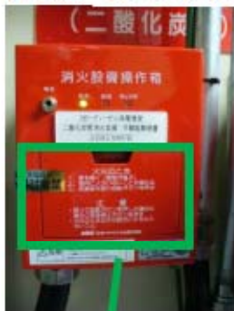
写真⑤ 消火設備操作箱
