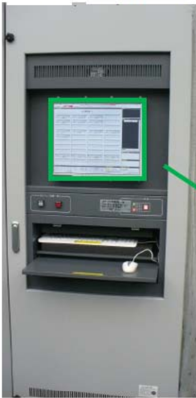
写真④ 中央制御室 総合操作盤
