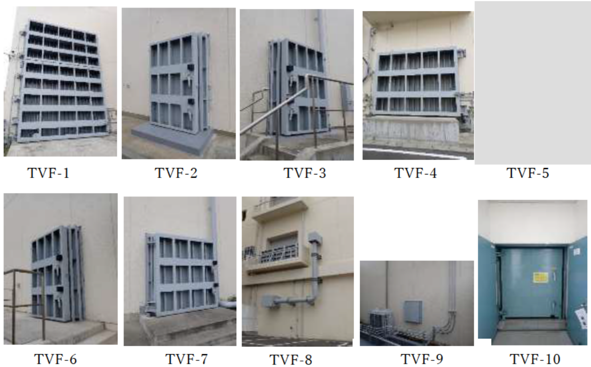
別図-2 浸水防止設備（浸水防止扉等）の設置状態
