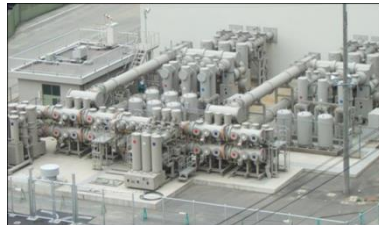
(a) 220kV 開閉所
