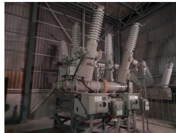
(b) 66kV 開閉所（屋内）
