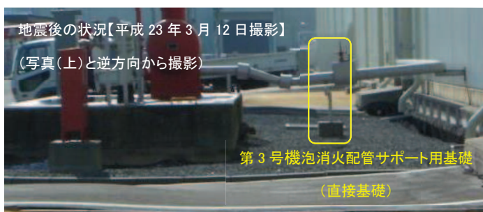
写真⑥' 沈下発生状況
