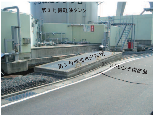
写真① 沈下発生状況
