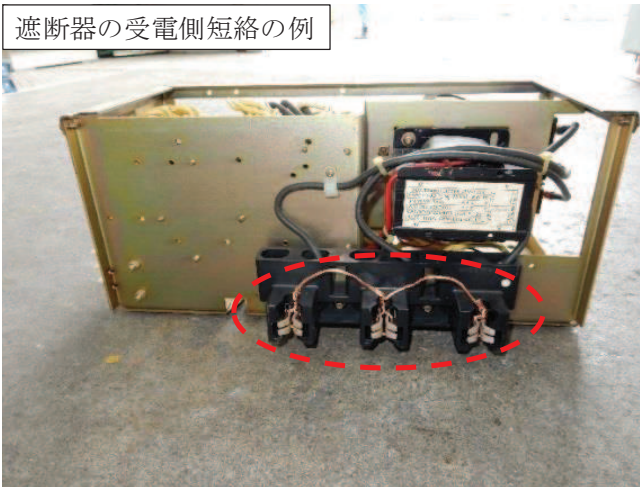
図 4.5.3 遮断器の短絡箇所 (MCC 試験時)
