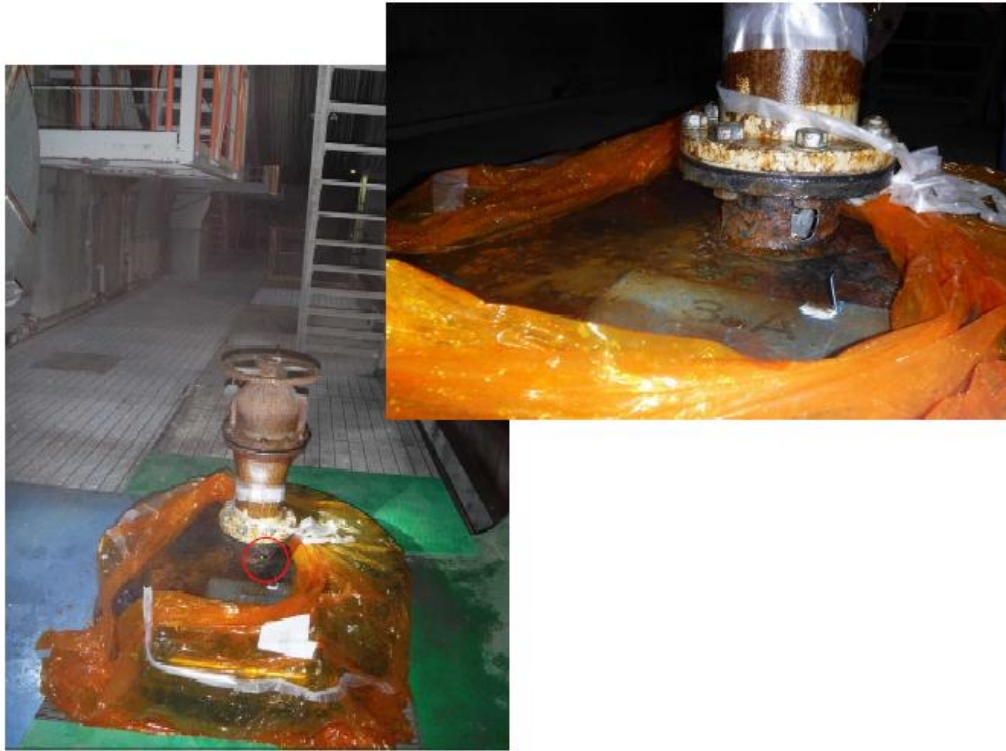
図1 漏えい後の当該ベント弁の写真
