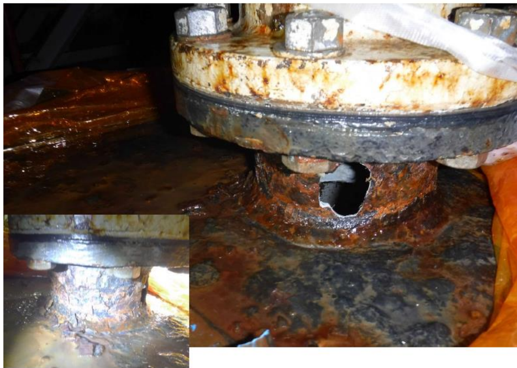
図2 漏えい箇所（貫通孔）の写真
