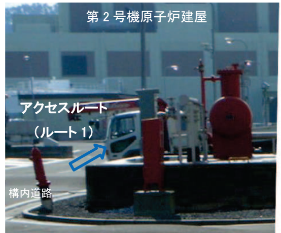
写真 C:地震後の状況【平成 23 年 3 月 12 日撮影】
