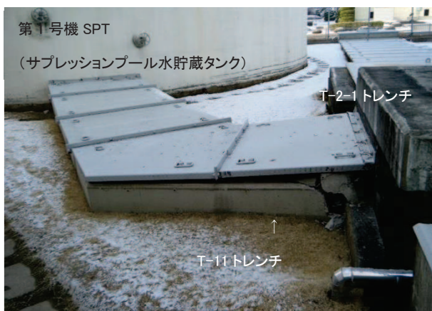
写真㉔ 沈下発生状況
