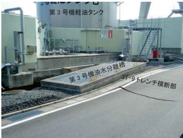
写真① 沈下発生状況
