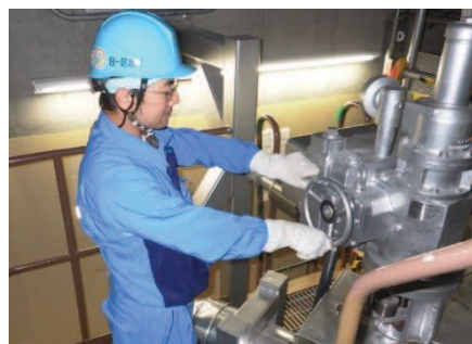
現場手動ハンドルによる閉操作
