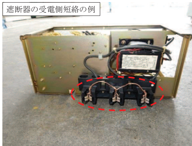
遮断器の短絡箇所 (MCC試験時)
