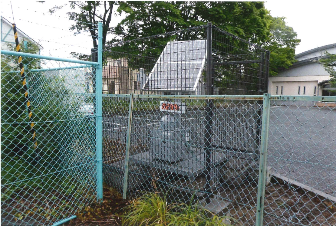
図 2-10-9(3) 移設後のモニタリングポスト (富岡第二小学校西の門横 (富岡町) : 2020年5月20日撮影)
