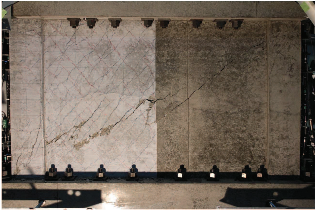
図 3-7 試験体 S-13-D I 最終破壊時写真
