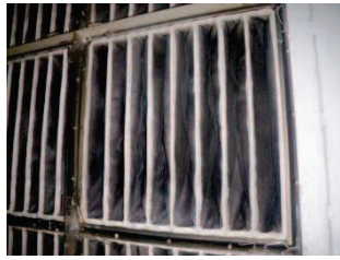
(バグフィルタ入口側)
