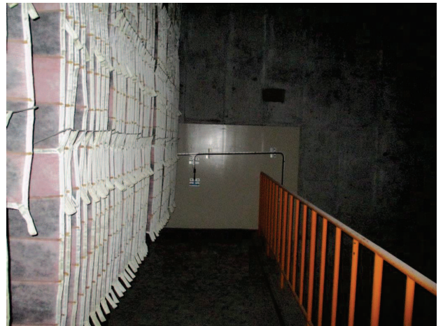
(バグフィルタ出口側)
