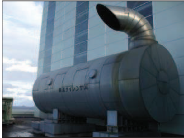
図1 ディーゼル発電機 排気管
