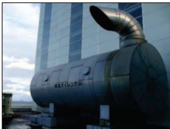
図 2.3-8 ディーゼル発電機 排気管
