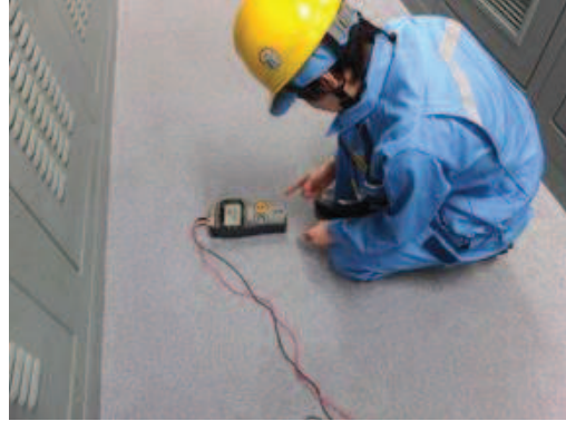
②電池容量確認
