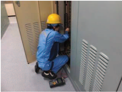
③可搬型計測器接続
