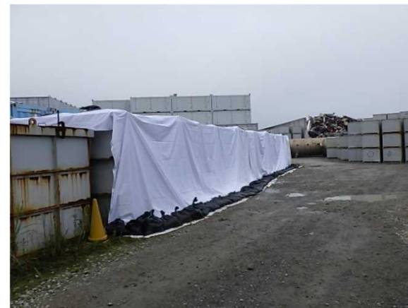
【ノッチタンク対策後(7月8日撮影)】
