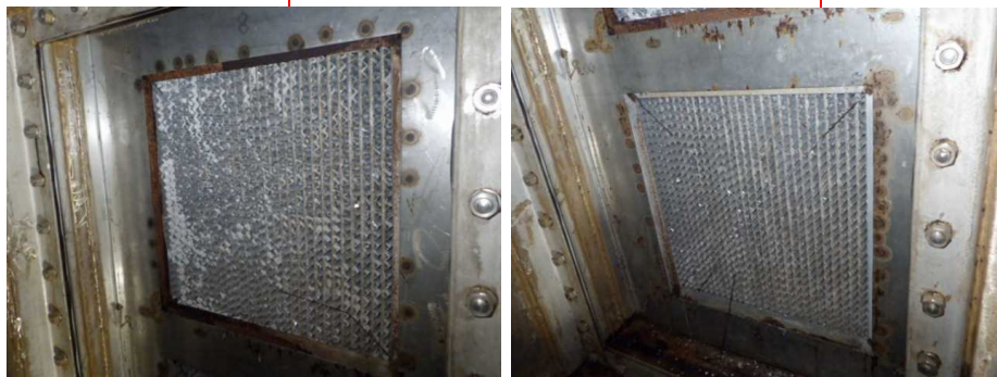
プレフィルタ (扉開放不可のため下流側から撮影)
