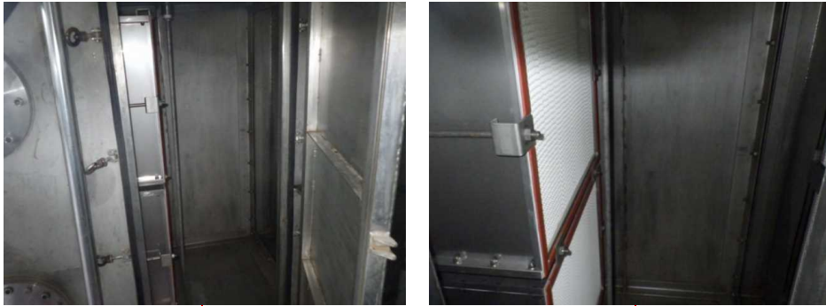
HEPAフィルタ (No.3)
