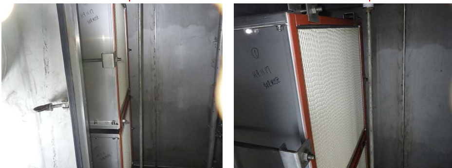
HEPAフィルタ (No.1)
