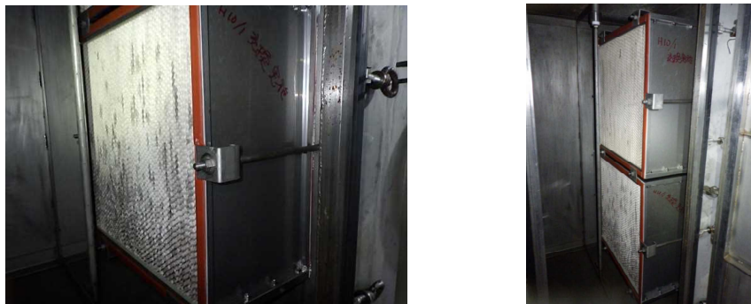
HEPAフィルタ (No.3)
