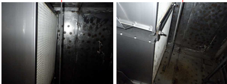
HEPAフィルタ (No.1)
