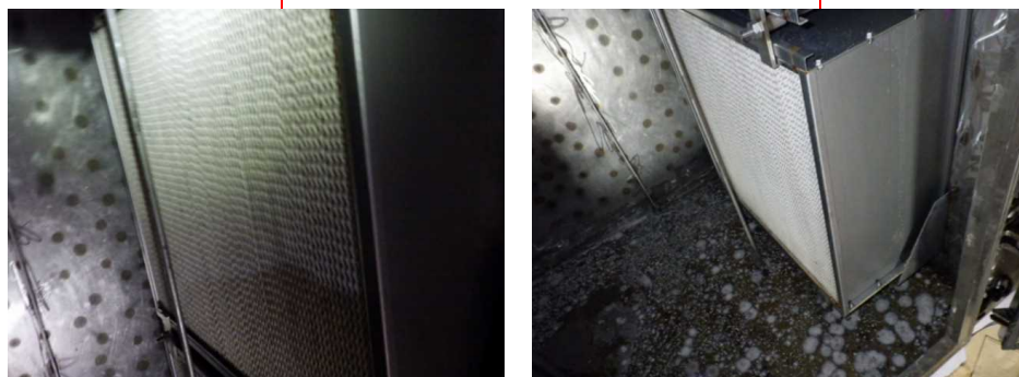
HEPAフィルタ (No.1) 底部に少量の溜まり水を確認
