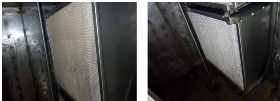
HEPAフィルタ (No.3)
