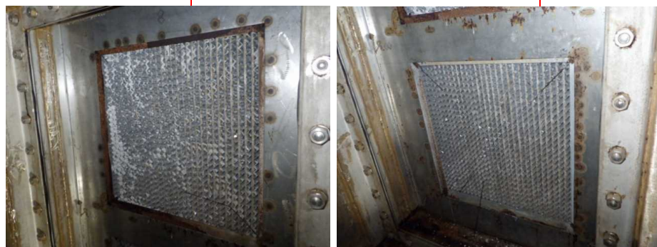
プレフィルタ (扉開放不可のため下流側から撮影)
