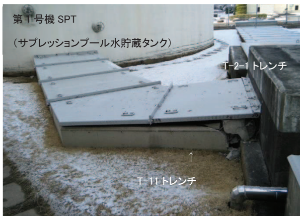
写真㉔ 沈下発生状況
