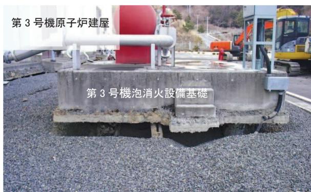
写真⑧ 沈下発生状況
