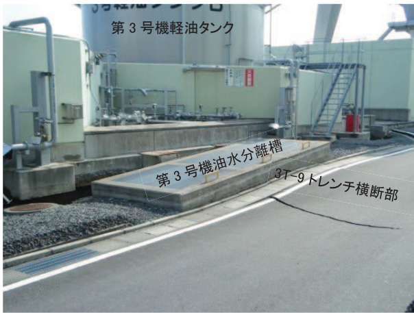
写真① 沈下発生状況
