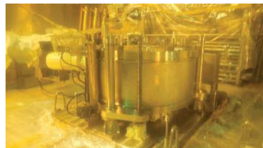
遠隔交換装置全景
