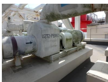
二次系の送水ポンプ
