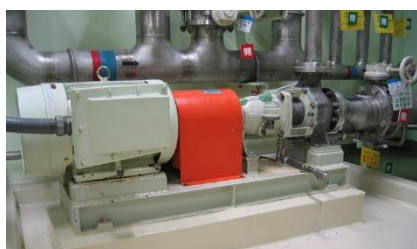
一次系の送水ポンプ
