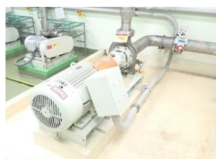
一次系の予備循環ポンプ
