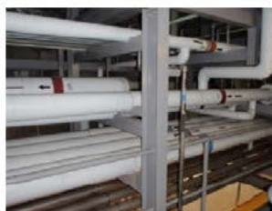
グレーチング通路横の配管スペース
