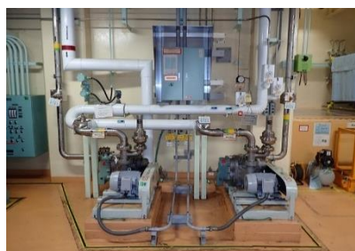
槽類換気系排風機
