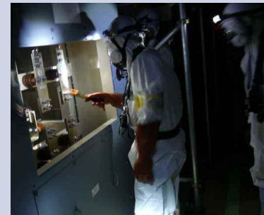
切替盤作業(SBO下想定)
