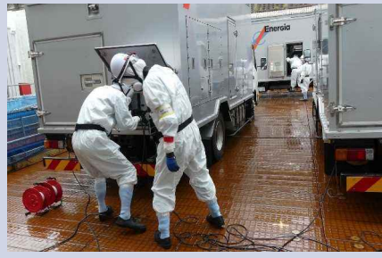
高圧発電機車始動前点検
