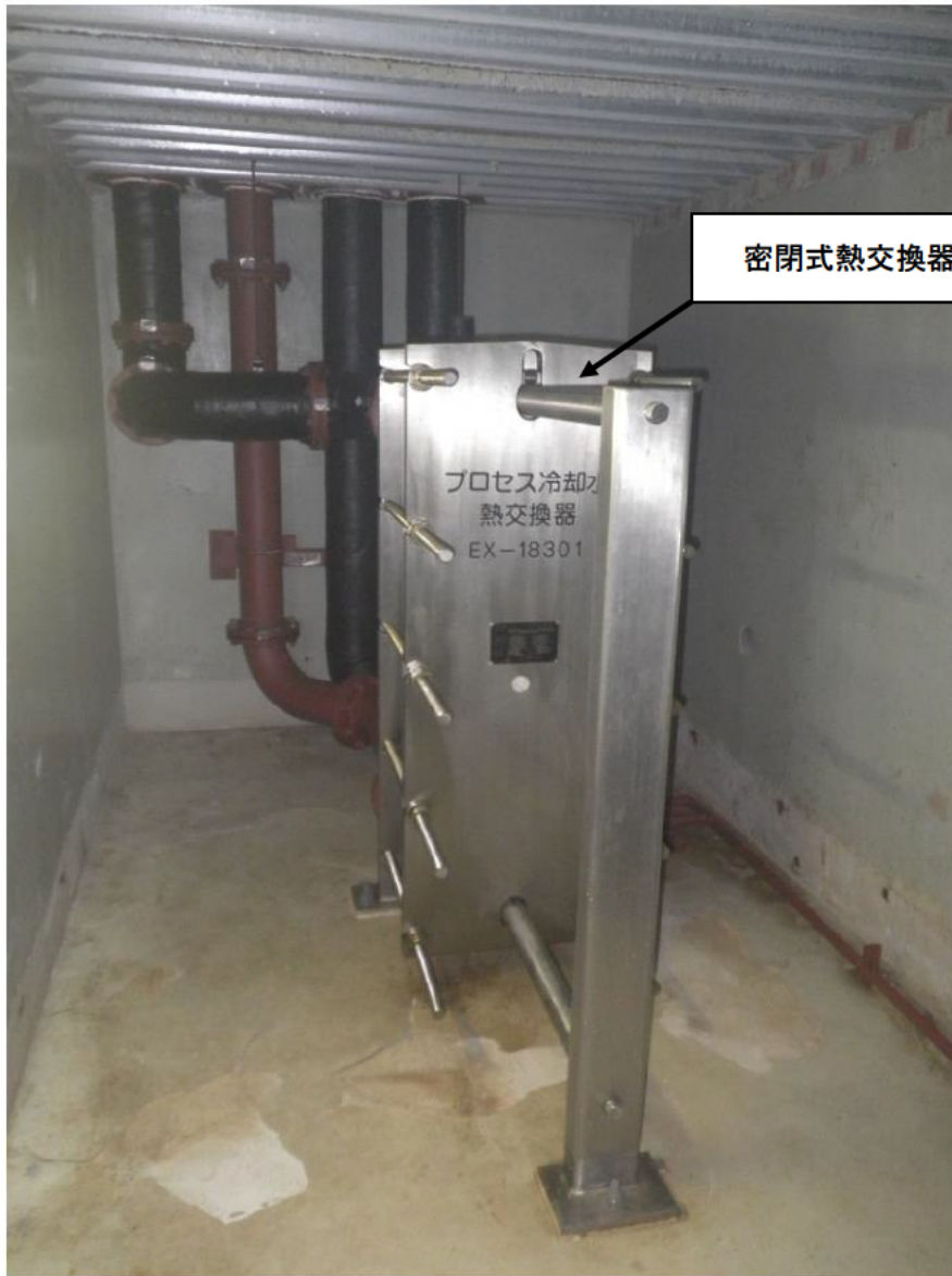
図3 現在の熱交換槽内部（角型ピット）
