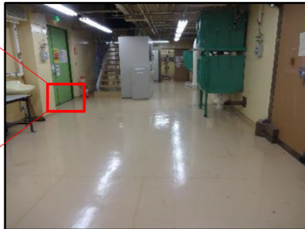
廃液処理室(IV)-1 【写真③】
