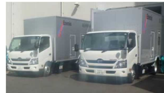
高圧発電機車
