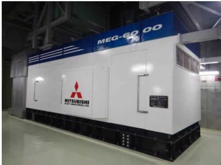
ガスタービン発電機
