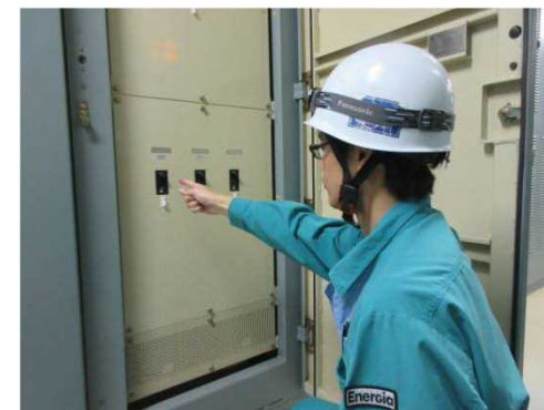
電源切替操作
