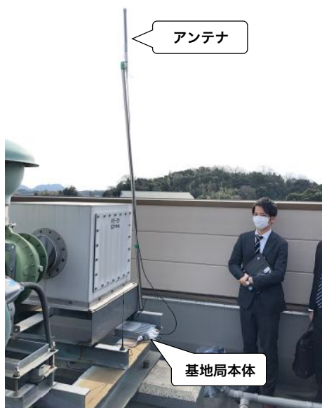
図 27 今回使用した基地局と同型のもの。ポール先端にアンテナがついている。
