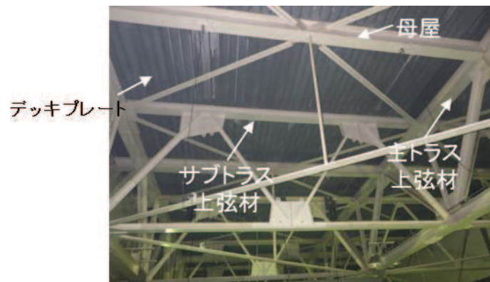
図 5.6-6 原子炉建屋原子炉棟天井の状況
