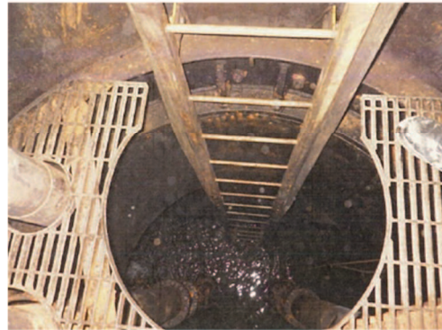
写真C 揚水井戸⑦(下段部) 2017/3/16撮影
