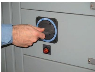
遮断器「切」操作
