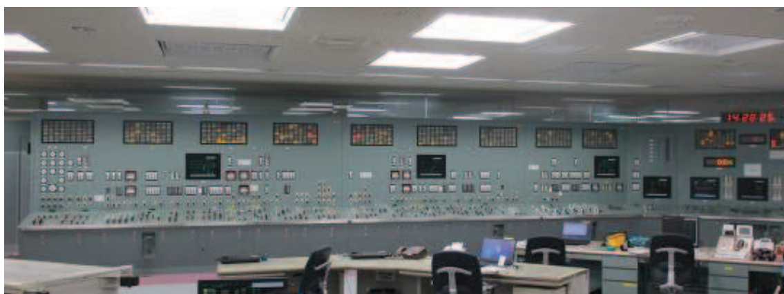
中央制御室主要盤配置
