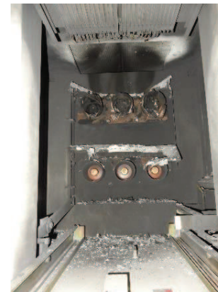
盤内開放部の状態 (M/C(D/G)遮断器室)
