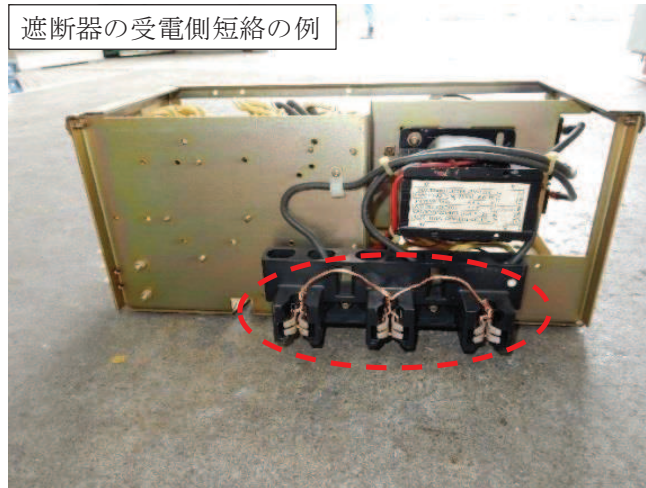
図 4.5.3 遮断器の短絡箇所 (MCC 試験時)
