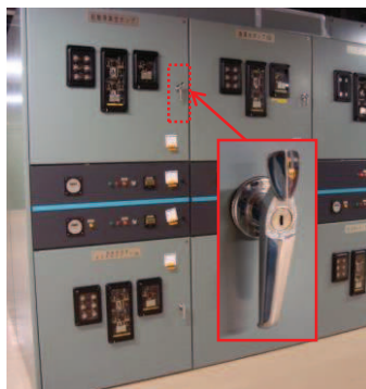
電源盤の施錠
