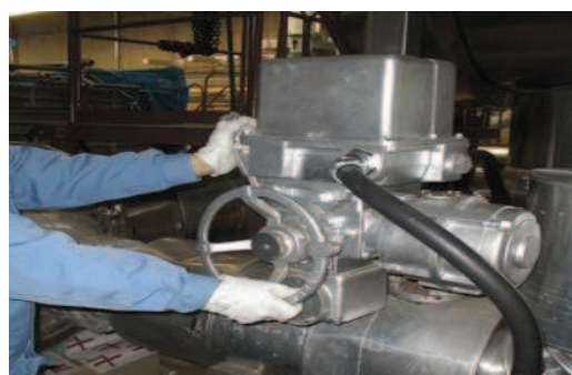
現場による電動弁の手動操作例
