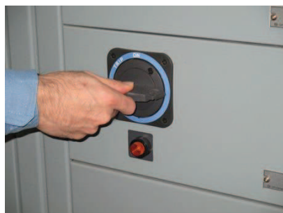
遮断器「切」操作
