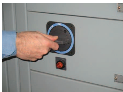
遮断器「切」操作
