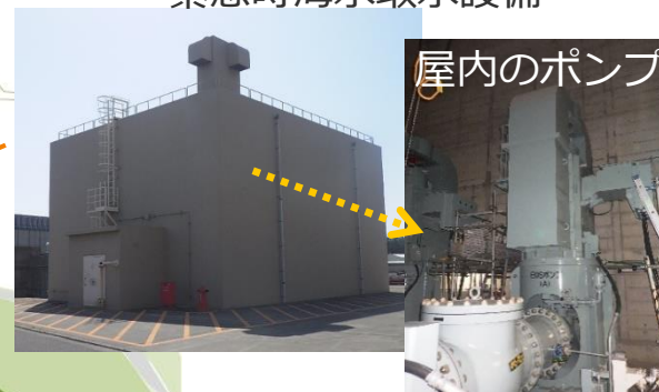
緊急時海水取水設備
