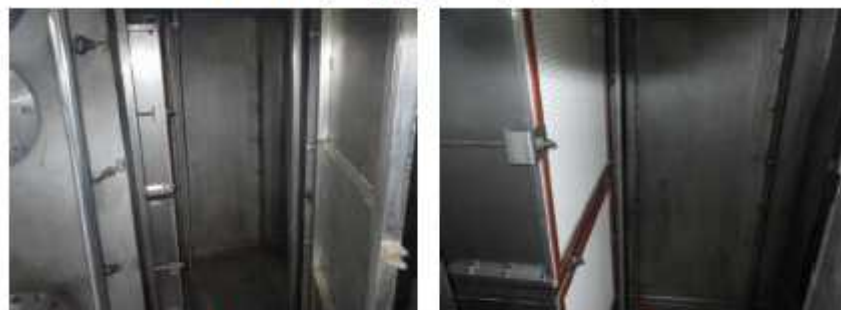
HEPAフィルタ (No.3)
