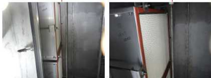
HEPAフィルタ (No.1)
