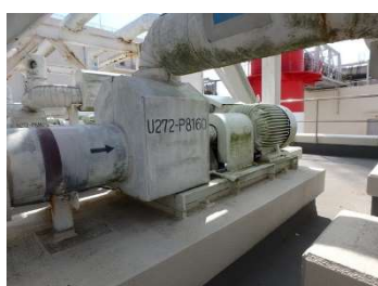
二次冷却水ポンプ
