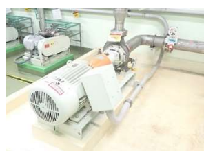
一次冷却水予備ポンプ
