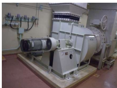
建家換気系排風機
