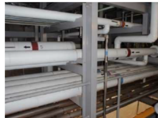
グレーチング通路横の配管スペース
