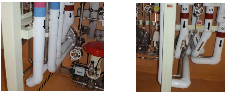
図-1 配管分岐室におけるセル貫通部の蒸気配管等の設置状況
