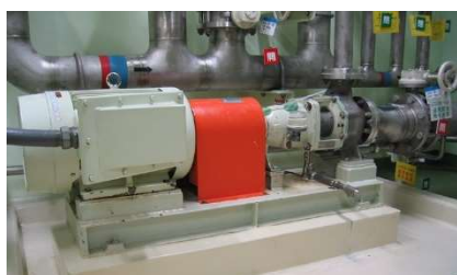
一次冷却水ポンプ
