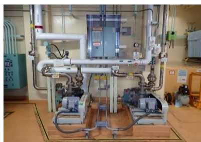
槽類換気系排風機
