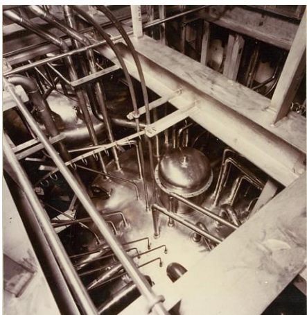
中間貯槽 (V37)
