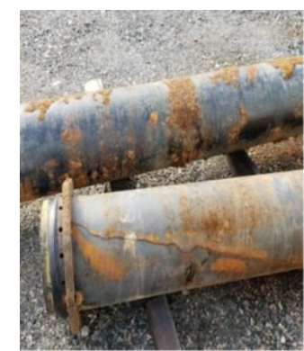
図 サリー原子力発電所で確認された消火水配管の破断状況
