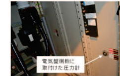
※絶縁アタッチメントについては、電源盤内の側板、正面扉に取り付けてあり、盤内部の圧力が測定できるように盤表面からねじ込み取り付けている。
